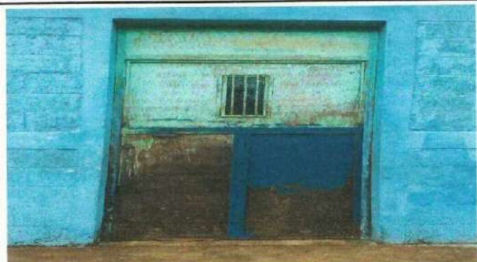
Foto 1: Sustrucción de pintura en paredes
