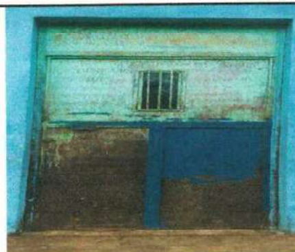
Foto 4: Sustrucción de una puerta.
